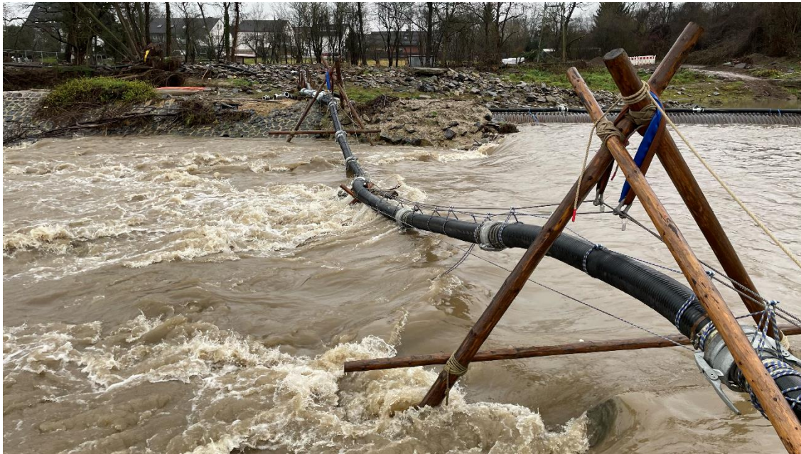
Erstmaßnahme THW unmittelbar nach Flut
